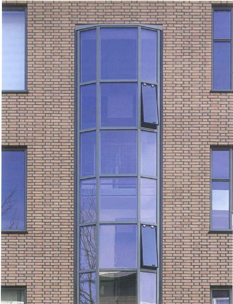
De kunststof kozijnen zijn vervangen door de nieuwste typen aluminium kozijnen, voorzien van een poedercoating.
