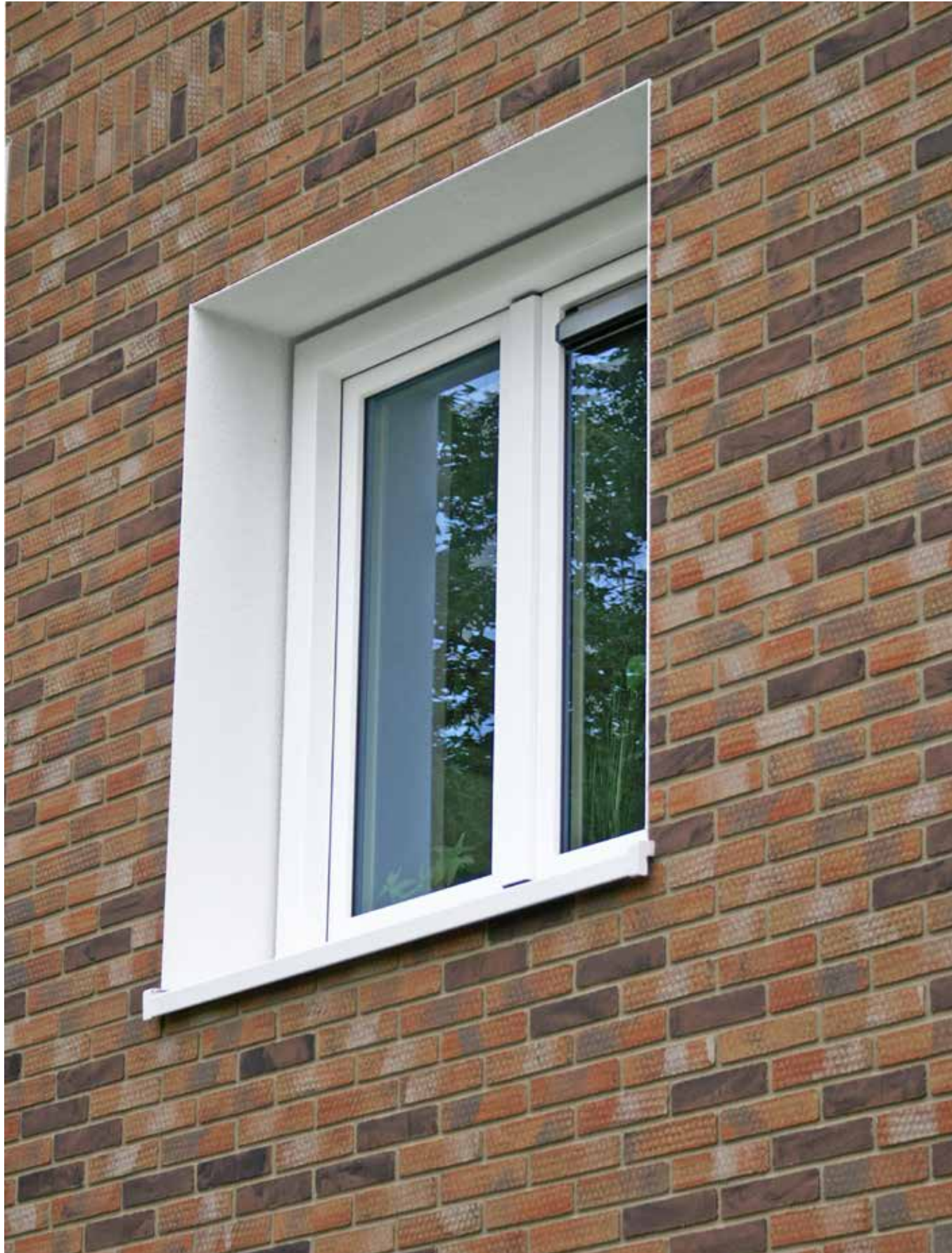
Een detail waar IJsselmonde veel aandacht aan besteedde, is de afwerking van de neggekant van de kozijnen.
